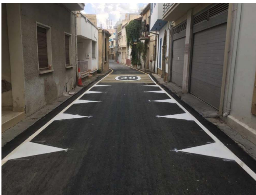
Εικόνα 28: Διαμόρφωση οδού ήπιας κυκλοφορίας με συνύπαρξη πεζού και οχημάτων στο επίπεδο του οδοστρώματος
